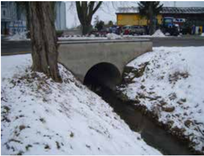
Abbildung 37: Schwachstelle Halbach, Durchlass QP113.
