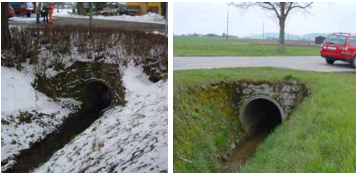
Abbildung 38: Schwachstellen Tüfenbach, Durchlass QP114 (Foto links) und Durchlass QP116 (Foto rechts).
