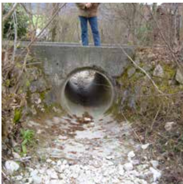
Abbildung 23: Durchlass beim Staanackerwegli.
