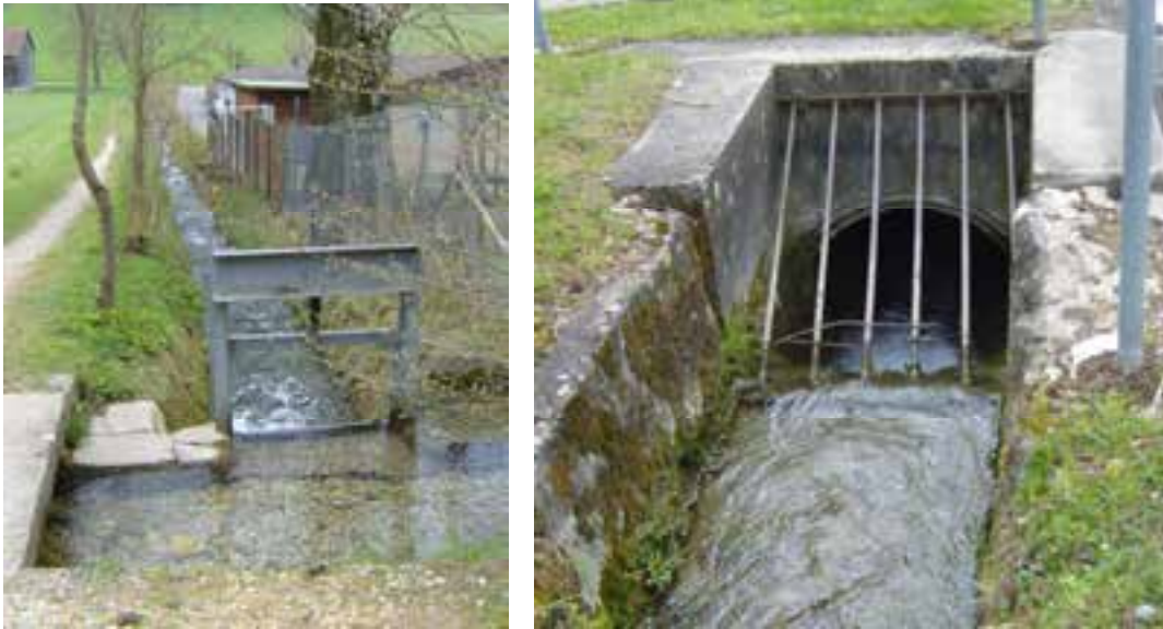
Abbildung 40: Schwachstellen Lieblosentalbach, Durchlass QP407 (Foto links) und Eindolung QP410 (Foto rechts).
