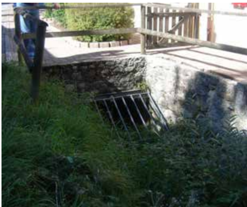
Abbildung 41: Schwachstelle Langtalbach, Durchlass QP604.
