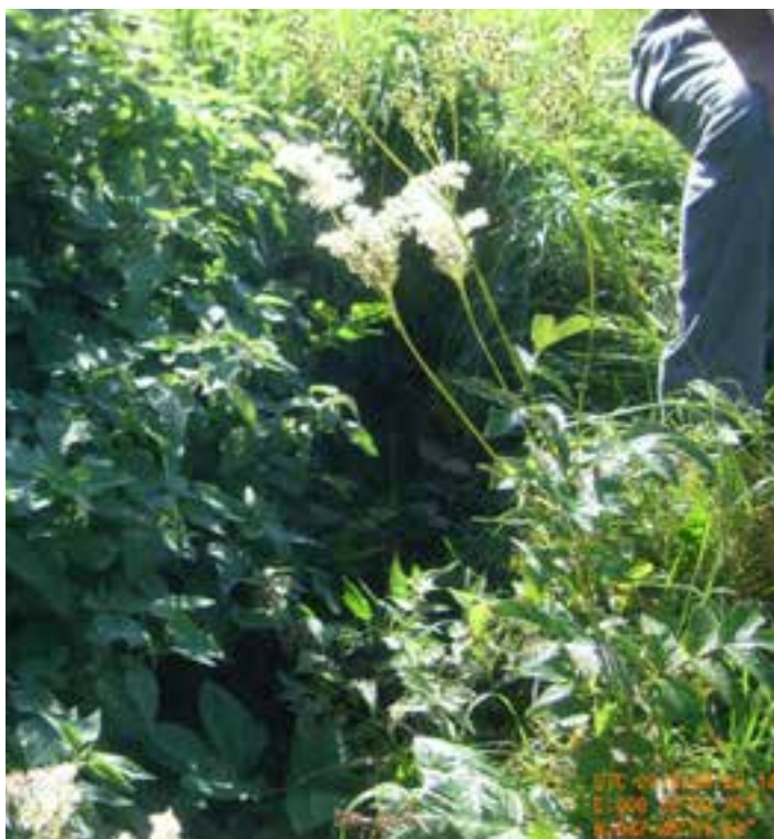
Abbildung 37: Schwachstelle Schwebelbach, QP208. Der Einlauf in die Eindolung (Kreisprofil, Durchmesser 0.6 m) ist wegen des starken Bewuchses kaum erkennbar.
