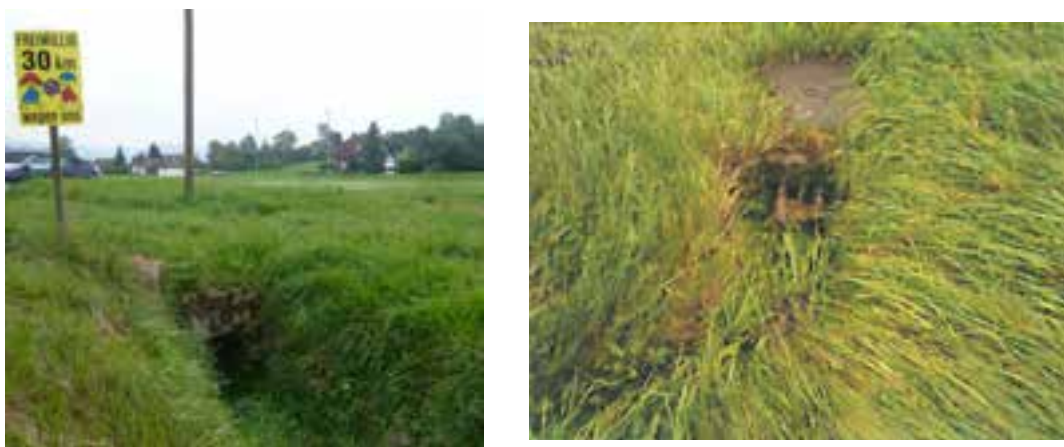
Abbildung 55: Schwachstelle Hindertalbach (links), Einlauf in Eindolung QP729. Schwachstelle Vordertalbach (rechts), verstopfte Zuleitung in die Eindolung beim Ereignis 17. Juni 2010).
