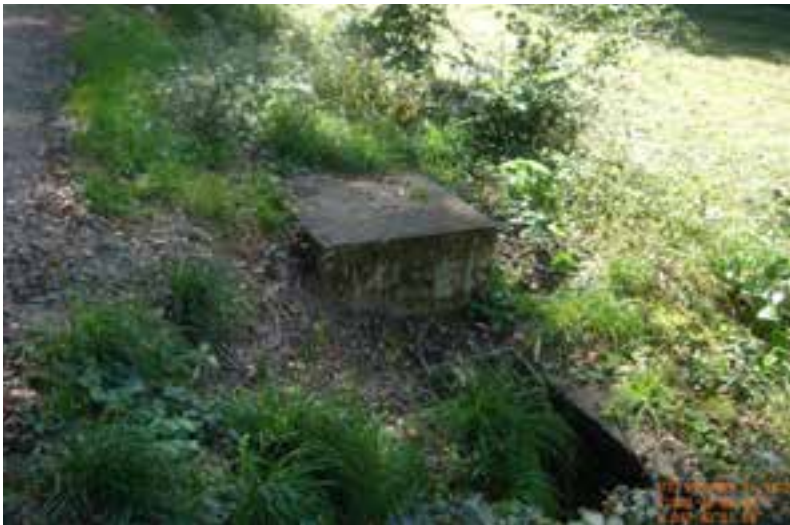
Abbildung 28: Schwachstelle QP17 (Einlauf in die Eindolung, Trapez-Profil).
