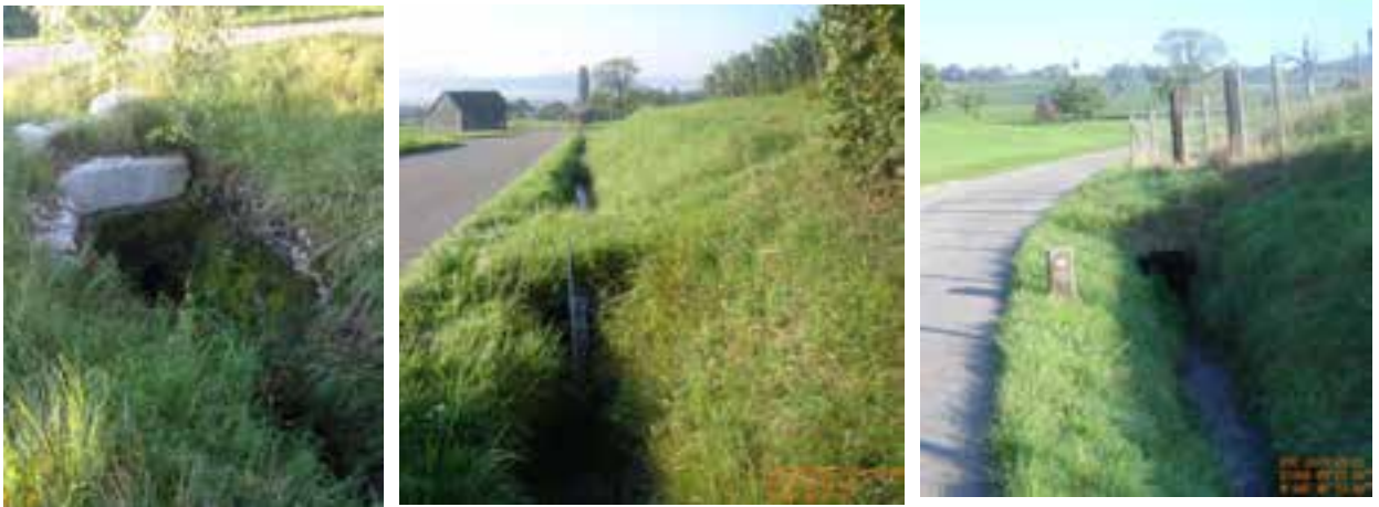
Abbildung 46: Schwachstellen Wingertengraben: Eindolung QP104 (links), kleine Übergänge zum Rebberg (Mitte), Eindolung QP680 (rechts).
