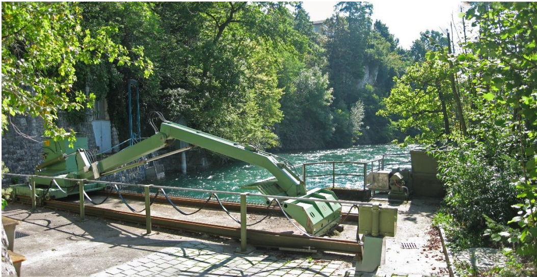
Bild 2: Einlaufbereich mit Rechenreinigungsanlage
