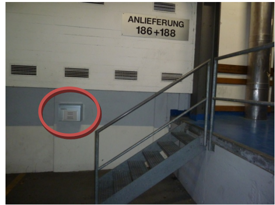
Abb.4: "Briefkasten", angeschrieben, neben der Treppe
